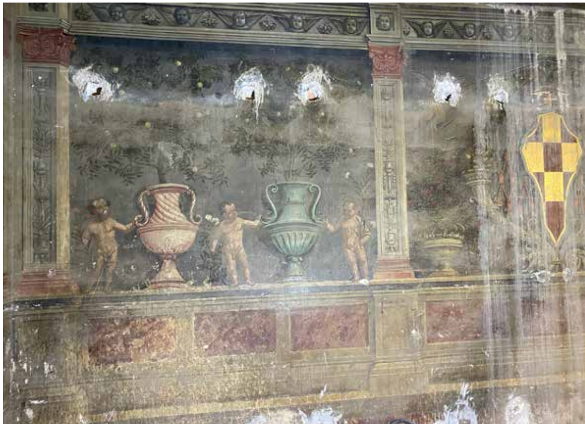
Detalle del estado de las pinturas que permanecían ocultas tras el armario del siglo XVIII.
